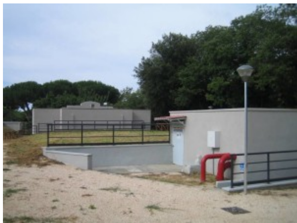
Centro Idrico Le Piagge di Genzano
