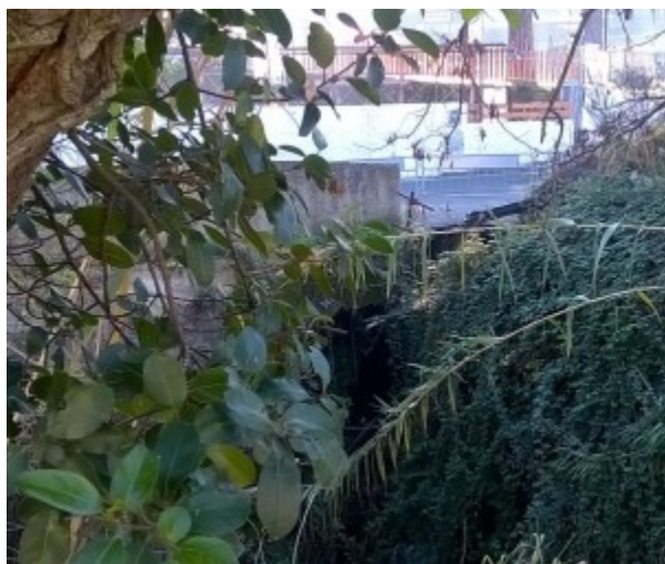
Il vuoto sotto il secondo ponte crollato a Cave di Peperino
