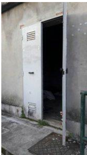
Albano, cabina elettrica aperta a via Tenutella
