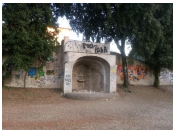
Degrado a Villa Sciarra di Frascati
